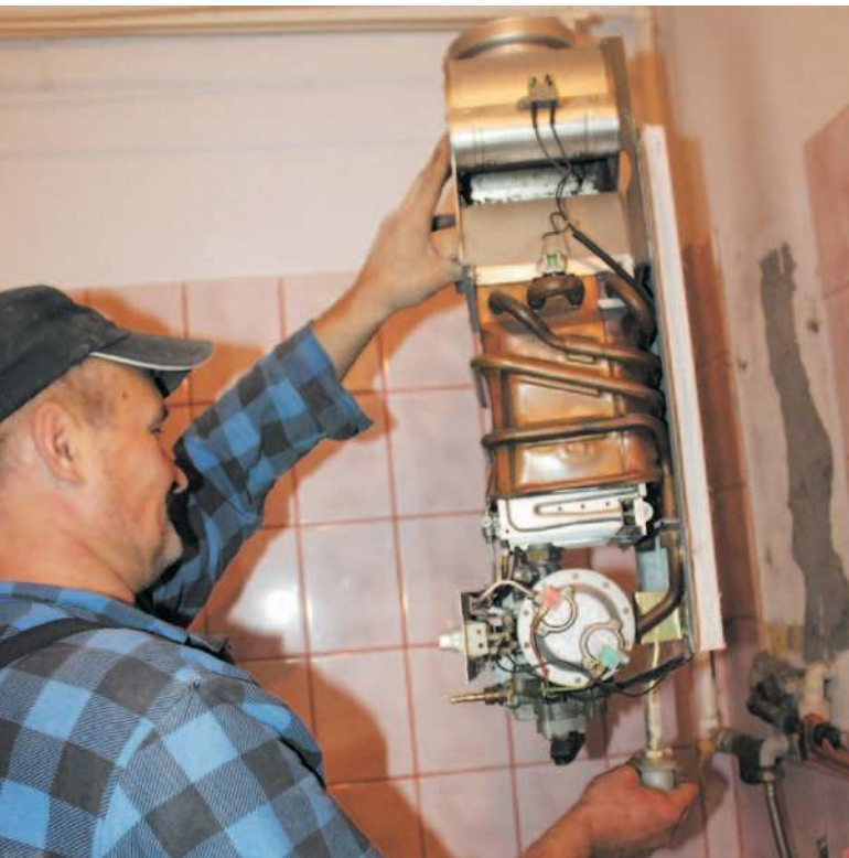
Po 45 latach, w najstarszych stalowowolskich wieżowcach przy ul. Okulickiego 4, 6, 8 i 10, gazowe termy odchodzą do lamusa
