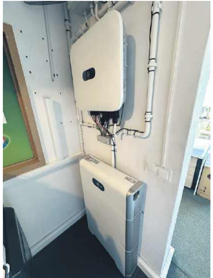
Na dole magazyn energii o pojemności 10 kWh, nieco wyżej falownik.
