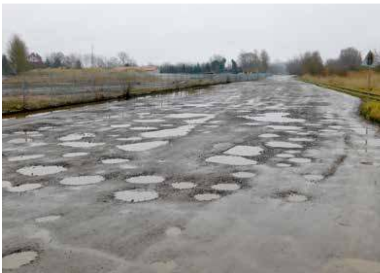
Ulica Pileckiego - dziury liczne i głębokie
