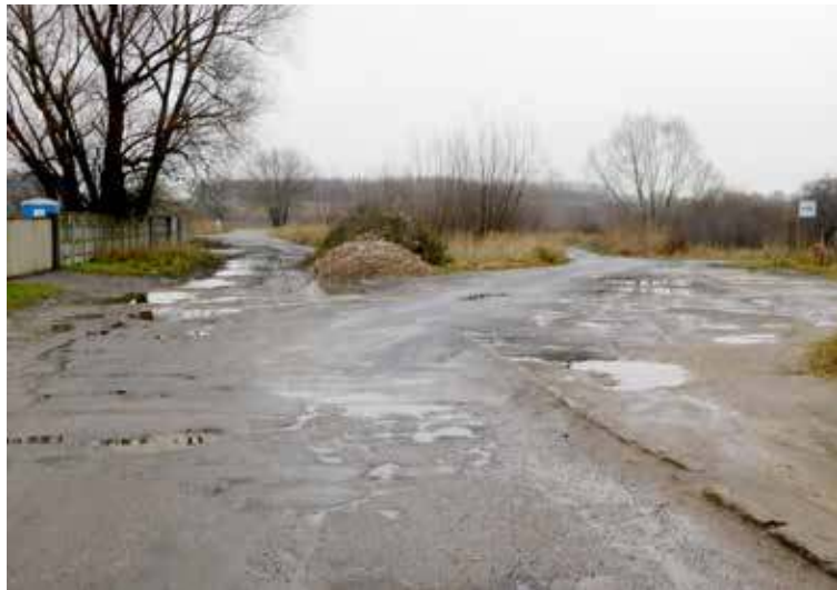
Wjazd od strony Boh. Warszawy też wymaga naprawy
