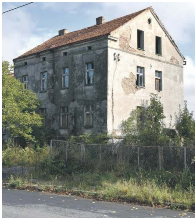
Tak wyglądają budynek i chodnik w Wierzbnie będące pod zarządem Starostwa Powiatowego w Oławie
