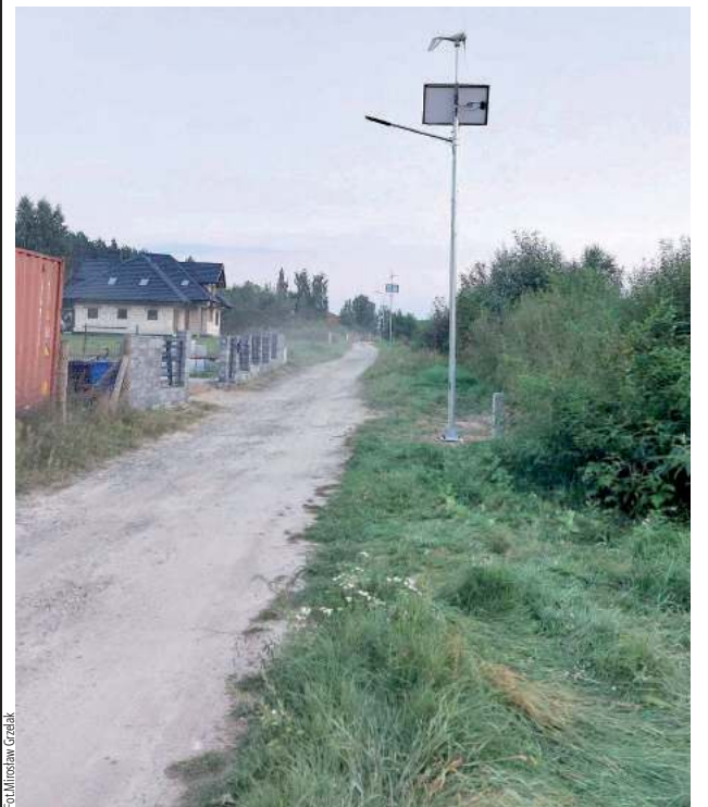
Pierwsze latarnie solarne w gm. Baranów zamontowano w trzech miejscach: na ul. Wschodniej w Baranowie, w Nowomichowskiej i częściowo w Klinie
