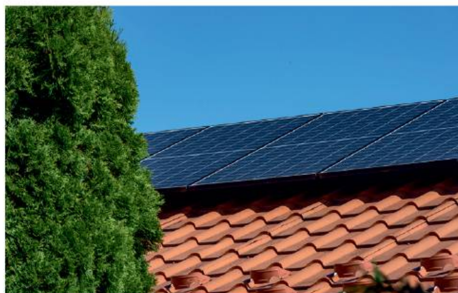
Instalacja odnawialnych źródeł energii.
