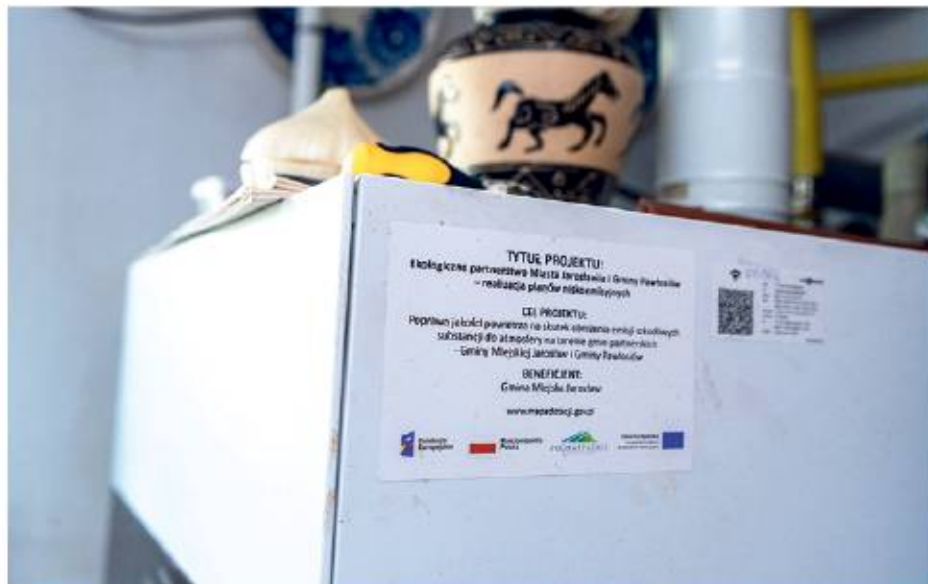
Instalacja kotłów gazowych kondensacyjnych oraz kotłów na biomase.
