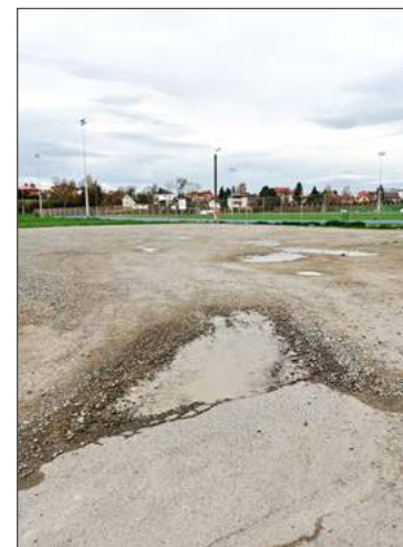
Na razie w koleinach stoi woda.
