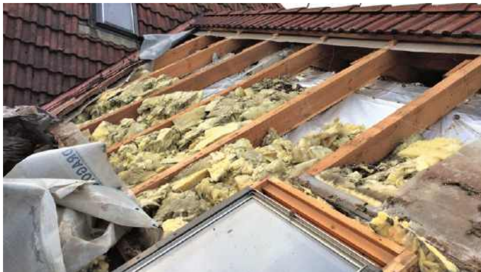
❗ Kuna domowa to niewielki drapieżnik, który może wyrządzić duże szkody. Na zdjęciu zniszczone przez to zwierzę ocieplenie dachu z wełny mineralnej. PCC PRODEX
