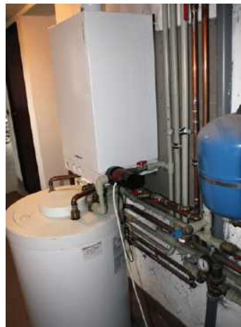
🔧 Właściele domów ogrzewanych paliwami kopalnymi, np. gazem ziemnym, muszą się przygotować na podwyżki. J. WERNER
