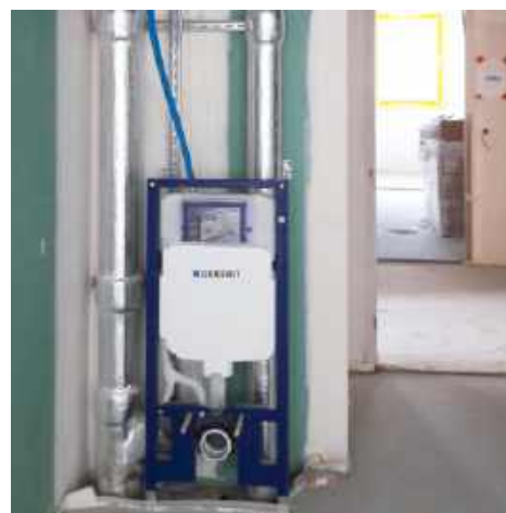
Zastosowanie niskoszumowych rur kanalizacyjnych i miękkich obejm z wkładką tłumiącą gwarantuje, że nocne korzystanie z WC nie będzie budzić domowników. ARMACELL
