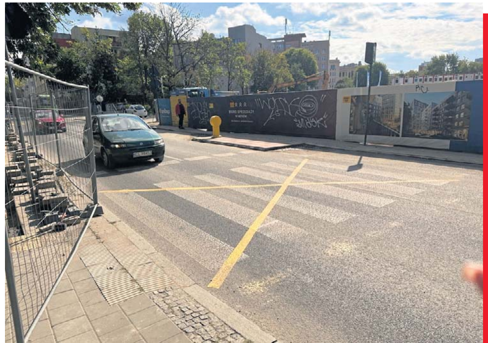
To przejście zostało wyłączone z ruchu...
