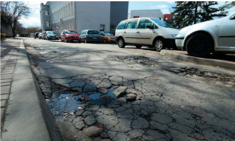
Problem dziurawej nawierzchni i wysokiego krawężnika na parkingu przy przychodni zdrowia prawdopodobnie zostanie rozwiązany
