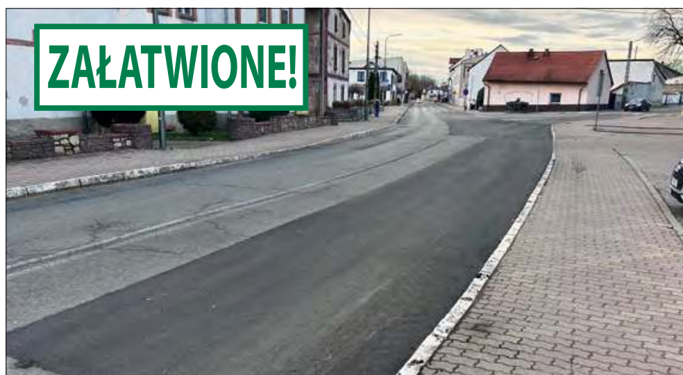
Niebezpieczne wybrzuszenie zniknęło.
