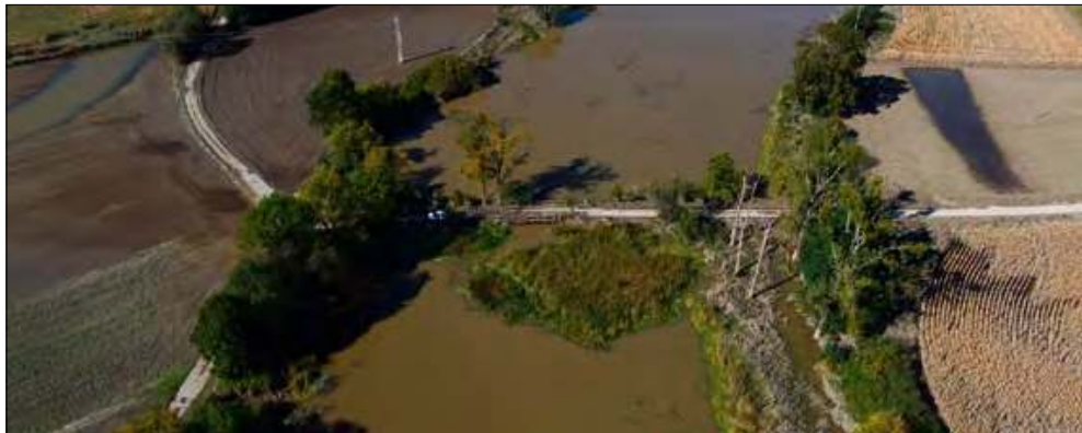
Trzciniowisko zablokowało przepływ wody pod mostem.
