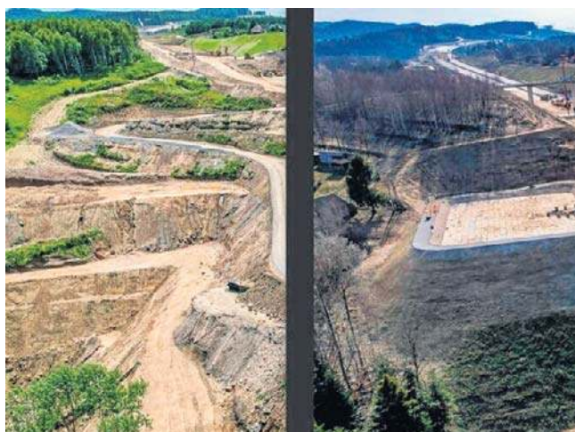
Zbiornik umożliwi kontrolowane odprowadzanie wód opadowych
