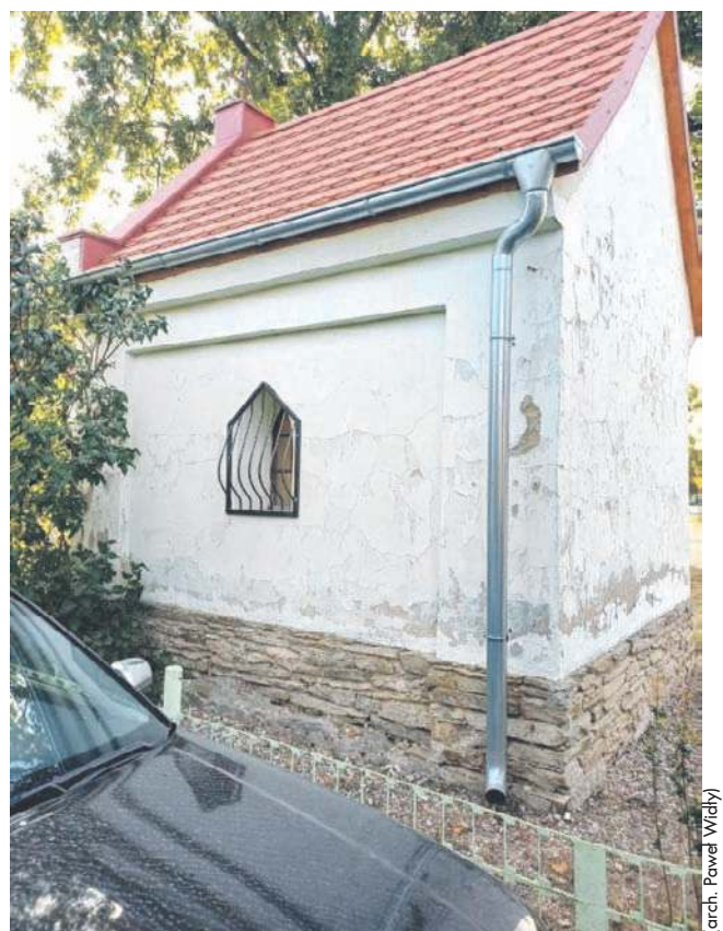
Elewacja kapliczki przed renowacją
