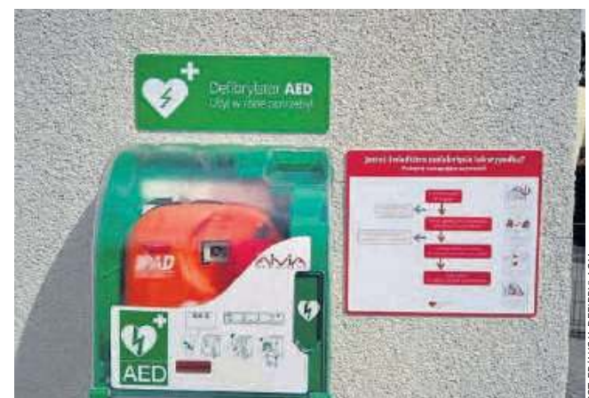
W ramach projektu w Szczecinku zamontowano i sprawdzono 14 urządzeń umieszczonych w skrzynkach zewnętrznych.
