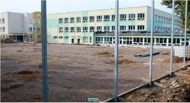
Mniejsze z boisk przy SP nr 30 jest już w przebudowie. Większe, na którym nasz Czytelnik widział ćwiczących uczniów również jest wyłączone z użytkowania w oczekiwaniu na remont
