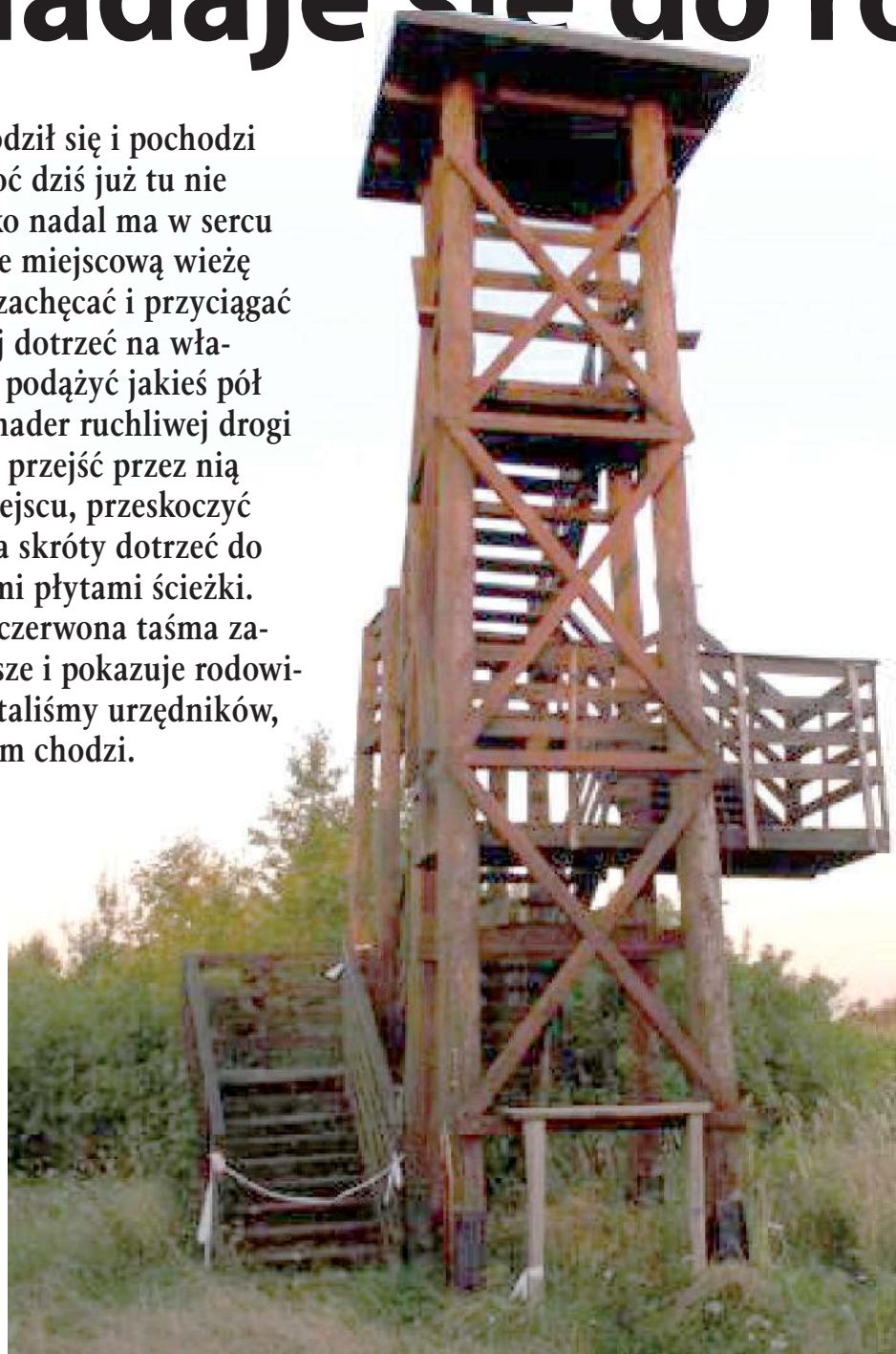
Wieża widokowa we Frampolu nadaje się już do rozbiórki
