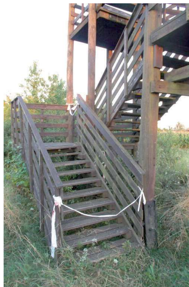
Upływ czasu, jak i materiał, z którego wykonana została wieża, nie pozwala na bezpieczne korzystanie z budowli
