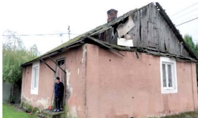
Dach na domu pani Krystyny jest w tragicznym stanie. Grozi zawaleniem
