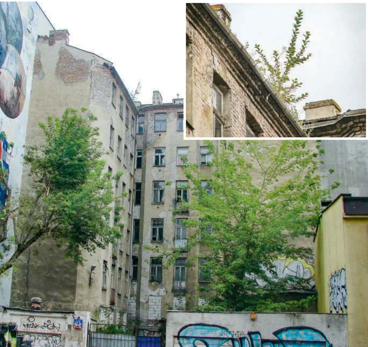
Oficyny przy ul. Żelaznej 22 i samosiejka rosnąca na dachu zabytku. | fot. Janusz Sujecki/Gazeta Polska
