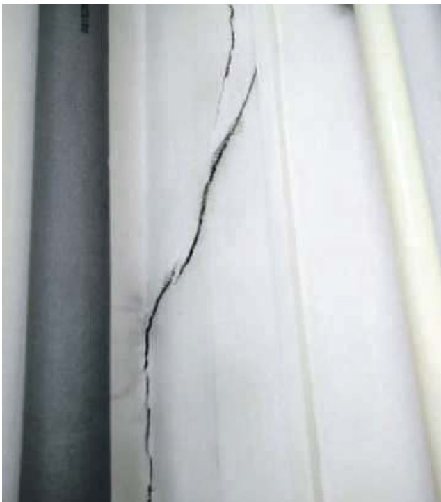
Na ścianach klatki schodowej pojawiły się pęknięcia
