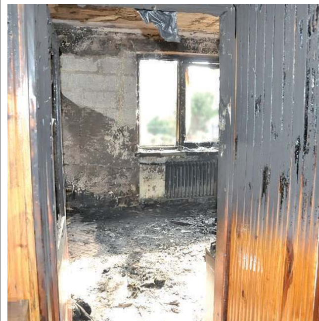
Spaleniu uległ pokój znajdujący się na parterze budynku wraz z wyposażeniem
