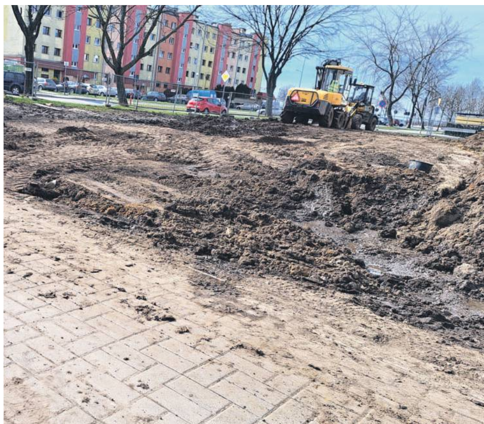
- Teren prac nie jest ogrodzony, koparki z ziemią czy kamieniami jeżdżą po chodnikach wewnątrz, a między tym chodzą ludzie - apeluje mieszkaniec. - Chyba nie tak to powinno wyglądać
