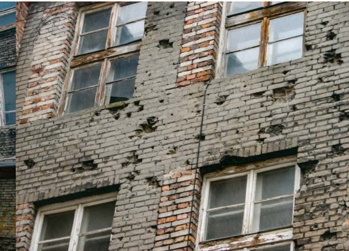
Budynek pofabryczny przy ul. Dobrej 26 i ślady ostrzału na jego elewacji
