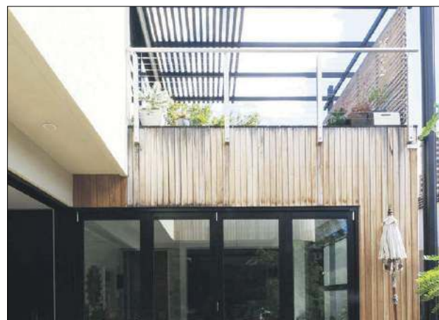
Pochłanianie przez drewno zanieczyszczenia połączone z wodą sprzyja powstawianiu takich naleciałości na powierzchni niezabezpieczonych desek elewacyjnych lub tarasowych
