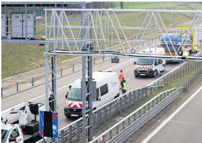
Instalacja kamer na trasie S19 pomiędzy węzłami Lublin Węglin, a Lublin Sławinek
