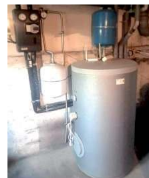
Zasobnik wodny oraz zespół sterujący instalacji solarnej
