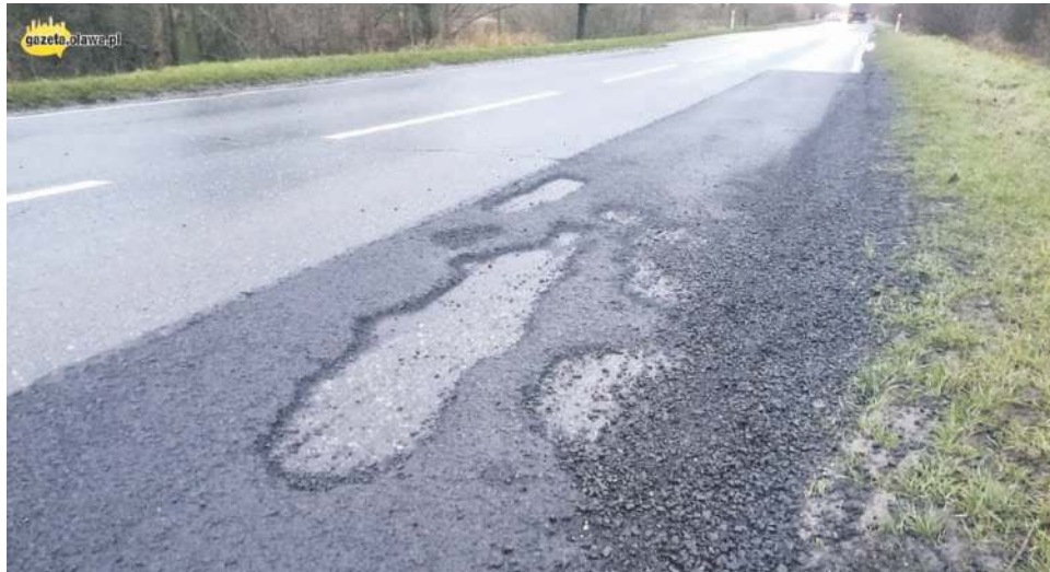
Dzień po tym jak połatano dziury, wyglądało gorzej niż przed remontem
