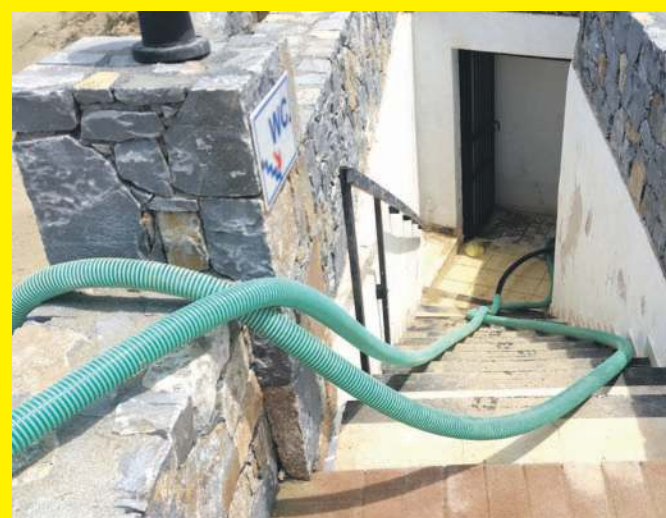
To wejście do nieczynnej toalety przy basenie
