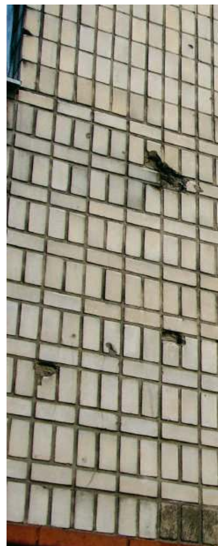
Ślady działań wojennych na elewacji modernistycznej
