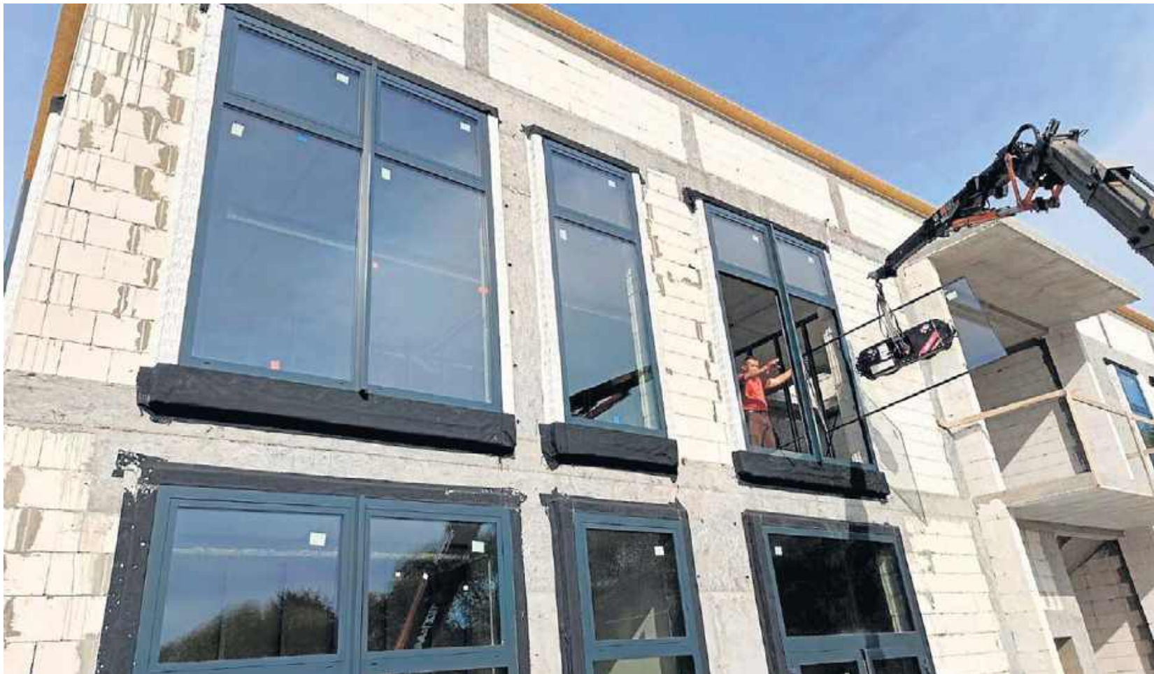
Ważne jest, aby ogrzane powietrze nie wydostawało się w sposób niekontrolowany na zewnątrz. Po pieniądze, które uciekają nam przez okno
