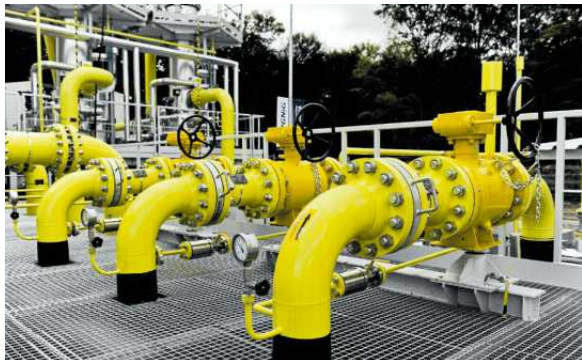
• Instalacja podziemnego magazynu gazu FOT. PATRYK OGORZALEK / AGENCJA WYBORCZA.PL
