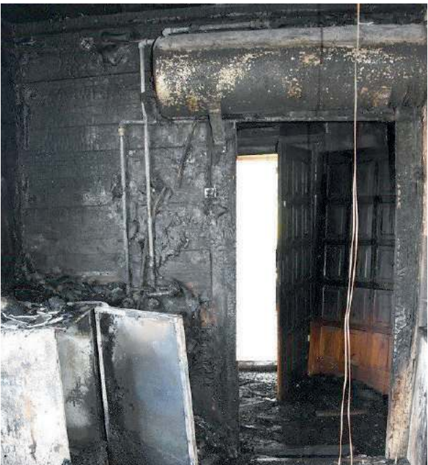
(McM) Częściowemu spaleni uległ parterowy dom. W jednym z pomieszczeń strażacy odnaleźli ciało - prawdopodobnie 32-letniego mieszkańca posesji
