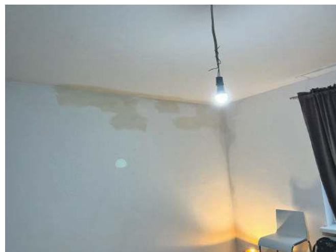
Tak wyglądały ściany w jednym z oddanych mieszkań
