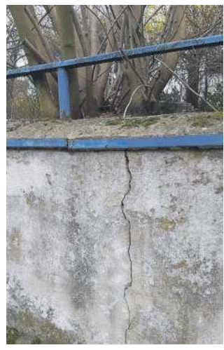
Korzenie nie wyciętych drzew rozsadzają mur
