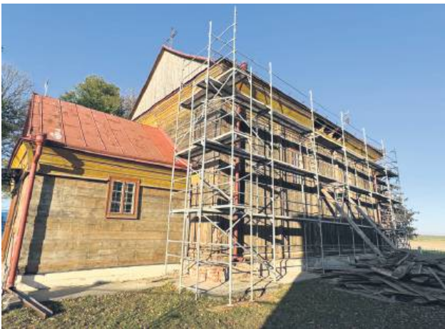
Za sprawą spróchniałych podwalin i zniszczonej konstrukcji świątyni groziła katastrofa budowlana, dlatego z dwóch stron podparto budynek grubymi 30-centymetrowymi balami.
