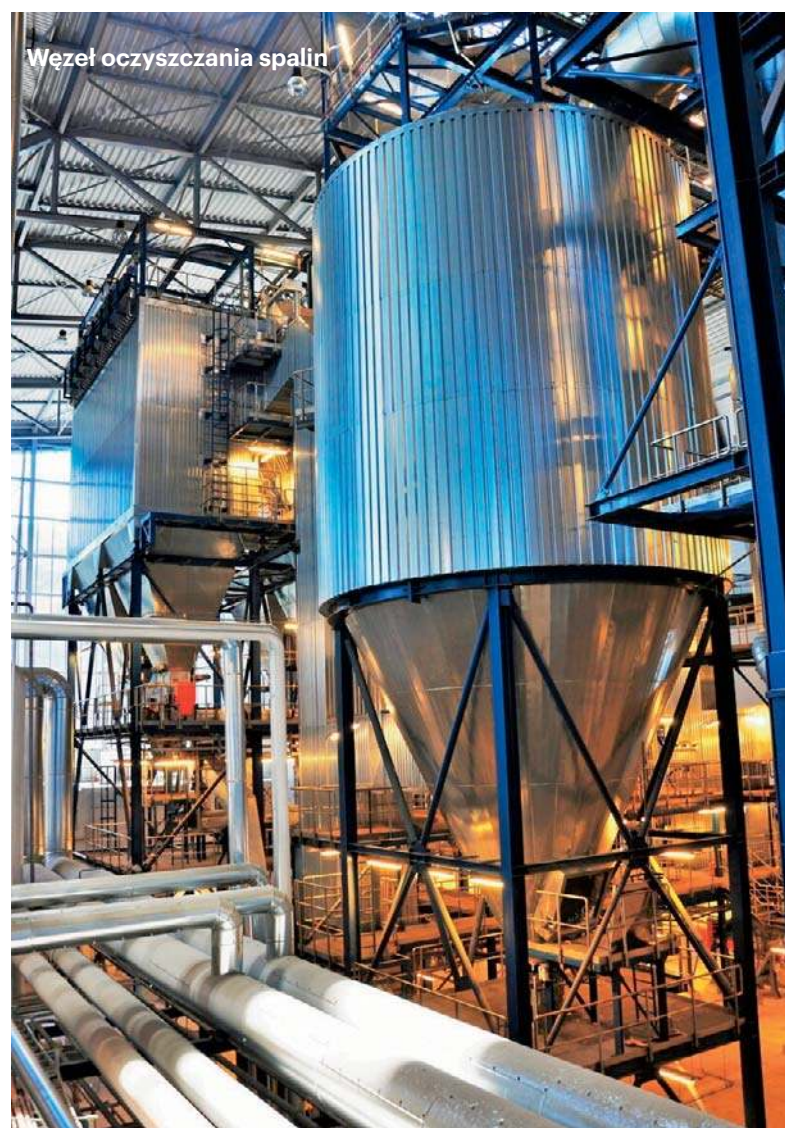
Instalacja odzysku ciepła ze spalin w krakowskiej spalarni
