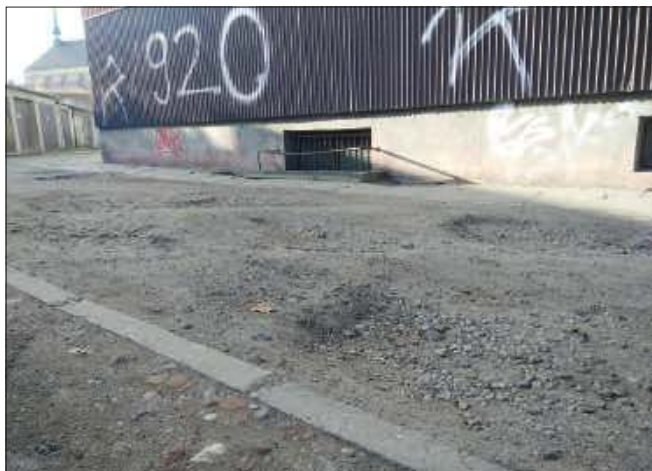
Przy wjeździe na osiedle przy ul. Głowackiego dziur w drodze jest więcej niż w szwajcarskim serze
