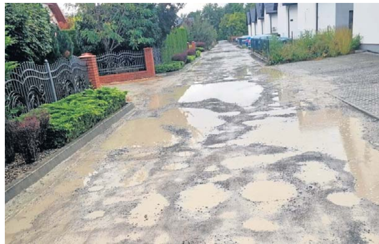
Czytelnicy z ul. Senatorskiej 53: tak wygląda nasza droga po deszczu
