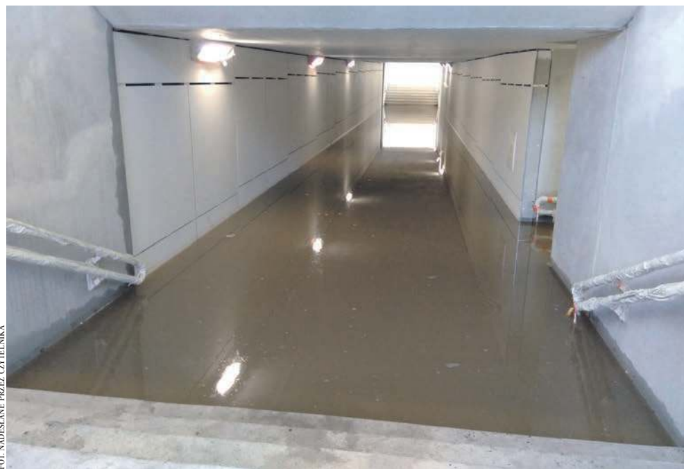
Woda w przejściu na ul. Zagrody po ostatnich deszczach sięgała poręczy
