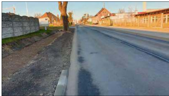
Mieszkańcy skarżą się m.in. na brakujące krawężniki.
