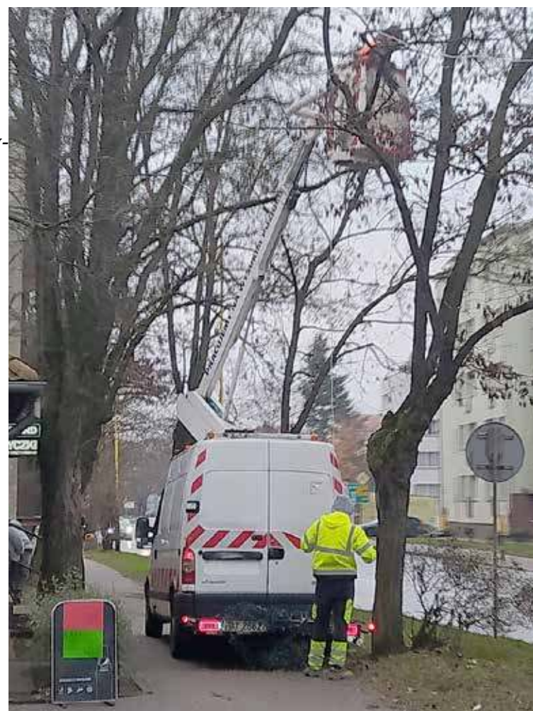
Naprawa uszkodzonych punktów oświetleniowych w gminie to prawie codziennosc. W przyszłym roku ma się to zmienić
