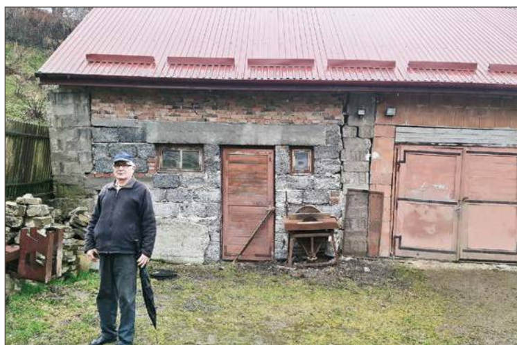
Budynek gospodarczy jest cały popękany. To skutek osunięcia się ziemi.
