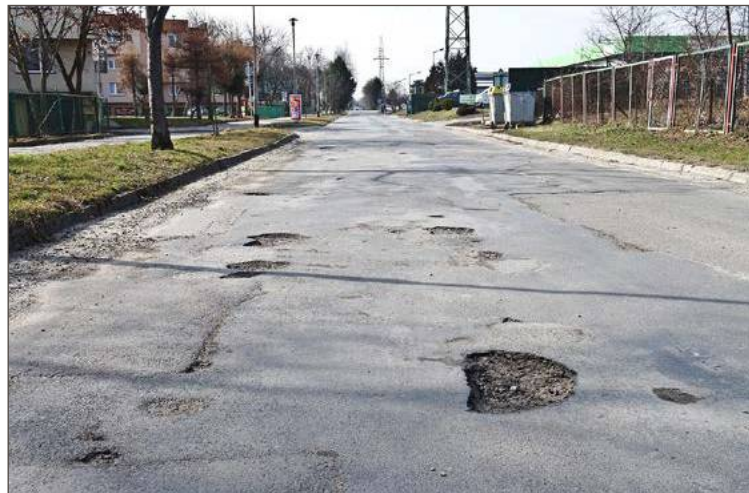
Ulica Brzegowa aż prosi się o nowy asfalt. Łatanie nic tam nie da.
