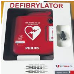
To pierwsze takie urządzenie w mieście zamontowane w miejscu publicznym.
