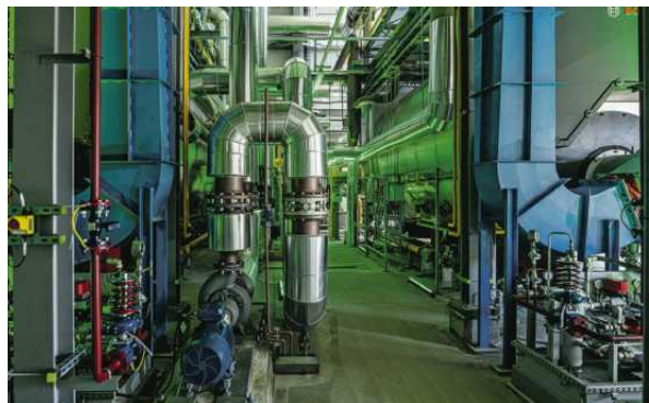
EC Gdynia_olejowo-gazowa kotłownia rezerwowo-szczytowa
