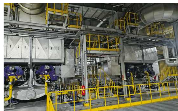
Kotłownia elektrodowa w EC Gdańsk
