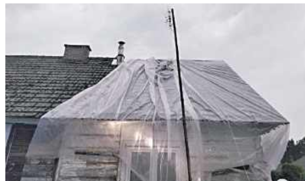
Strażacy pomagali przy zabezpieczaniu zerwanych dachów
