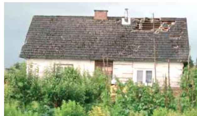
Wichura częściowo zerwała dach
