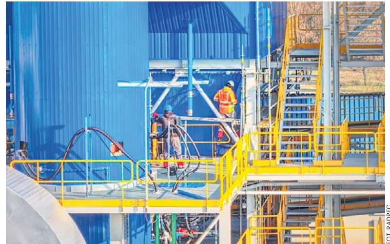
Ciepłownia Południe – jedna z dwóch radomskich ciepłowni dostarczająca energię ciepłą do radomskich odbiorców.
