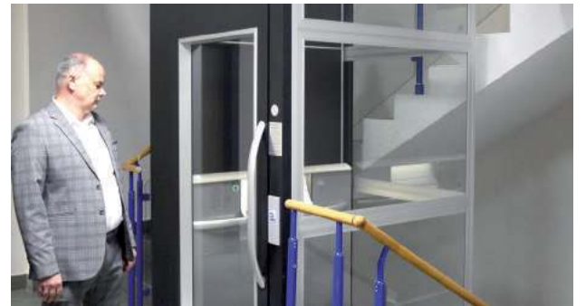
Sporym ułatwieniem w przemieszczaniu się po budynku nowoczesna winda
