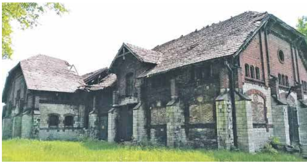
Zabudowania folwarczne robią wrażenie, niestety są w fatalnym stanie i jak na razie nie widać chętnych, żeby wyłożyć duże pieniądze na ich remont
