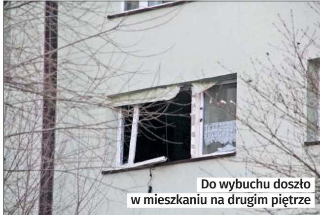
Eksplzja wyrwała okna i fragmenty elewacji budynku, które spadły na chodnik
