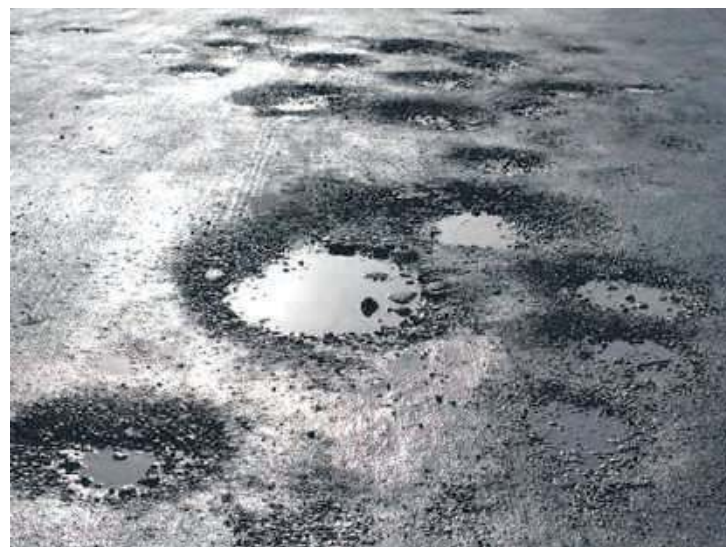
Droga Raciąż – Piastoszyn jest w kiepskim stanie. Przebudowa jest konieczna.
