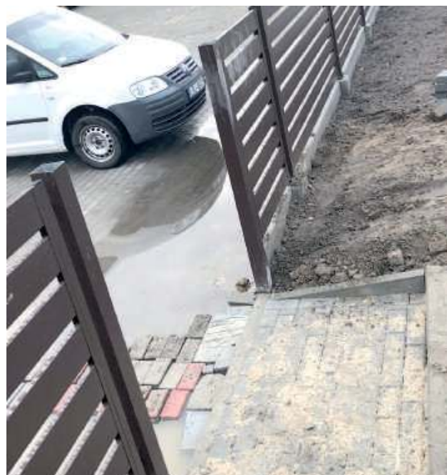
Spadek pobocza przy Szkole Podstawowej w Korczowie wykonano w kierunku szkoły. Woda spływa na plac szkoły, gdzie wykonano prowizoryczne schodki z cegieł. - Teraz woda, a w zimie będzie lodowisko. Czy nawet pod szkołą nasze dzieci nie mogą być bezpieczne? - pytają mieszkańcy
