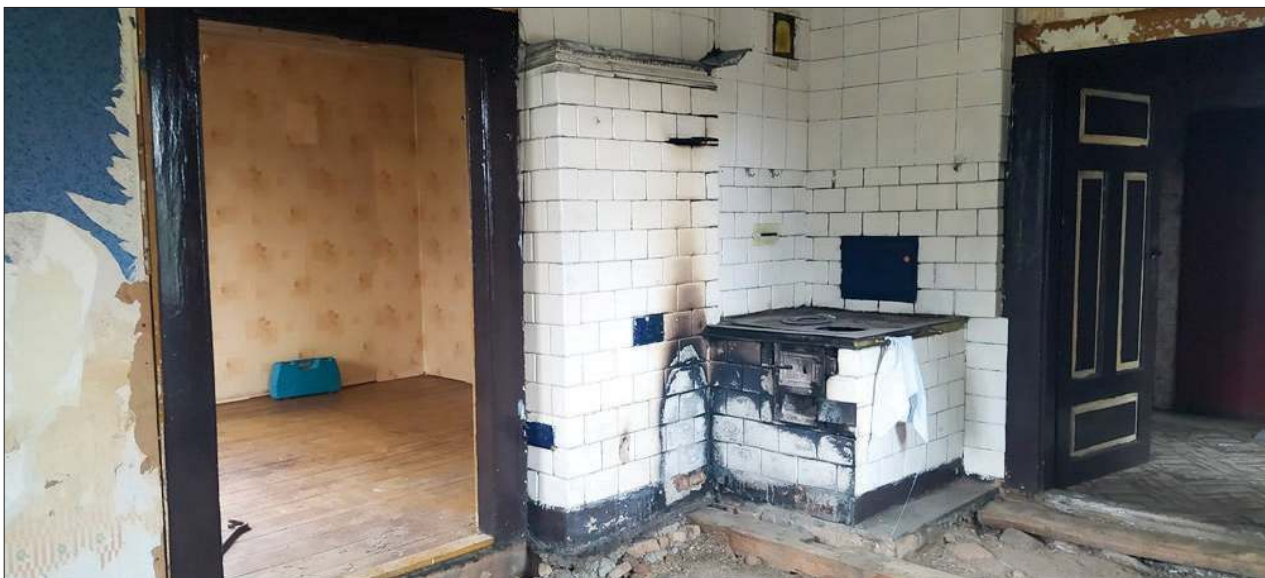
Cały dom wymaga remontu. Potrzebne są przede wszystkim materiały budowlane
