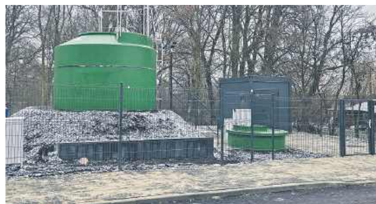
Oczyszczalnia ścieków w Brzezinach
