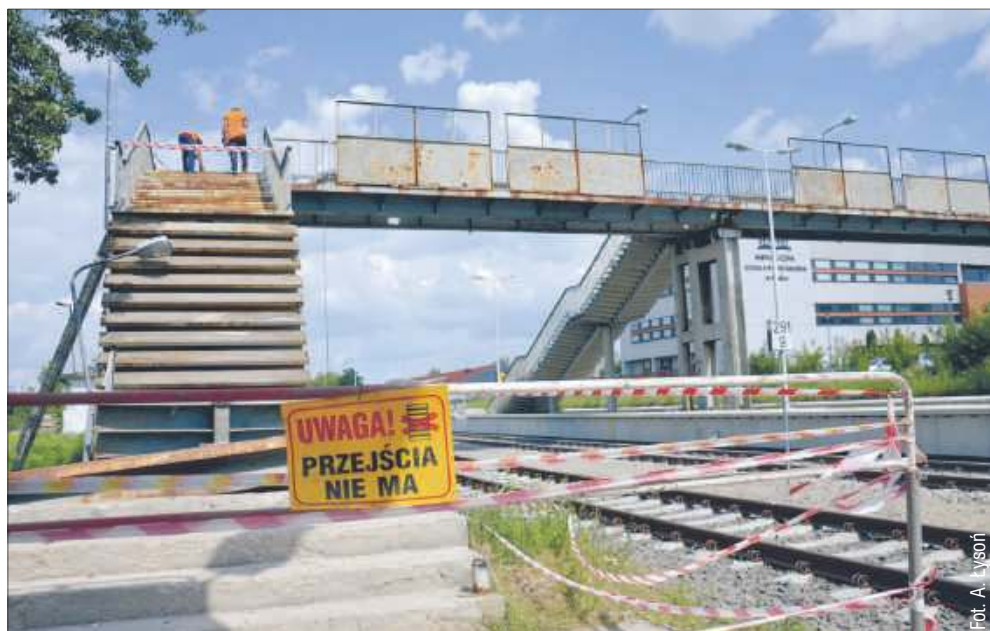
Metalowej kładki nad torami przy mieleckim dworcu PKP już nie ma.
